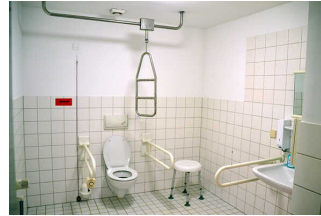
WC im Außenbereich
